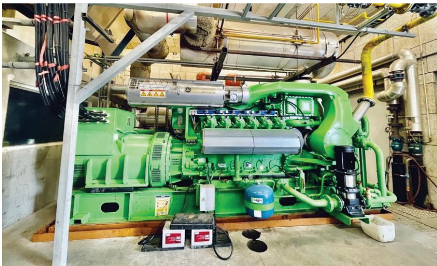
Záložní motor Jenbacher, který se spouští na základě potřeb sítě
