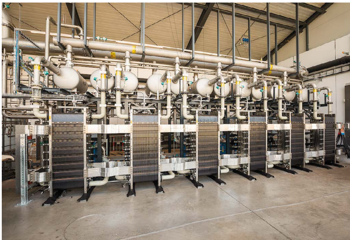
Obrázek 6: Šest PEM (Proton Exchange Membrane) elektrolýzérů s protonově výměnnou membránou separující z vody vodík a kyslík (zdroj: ©VERBUND)
