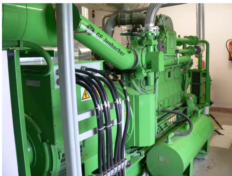
Obr. 8.5: Kogenerační jednotka fy GE Jenbacher
