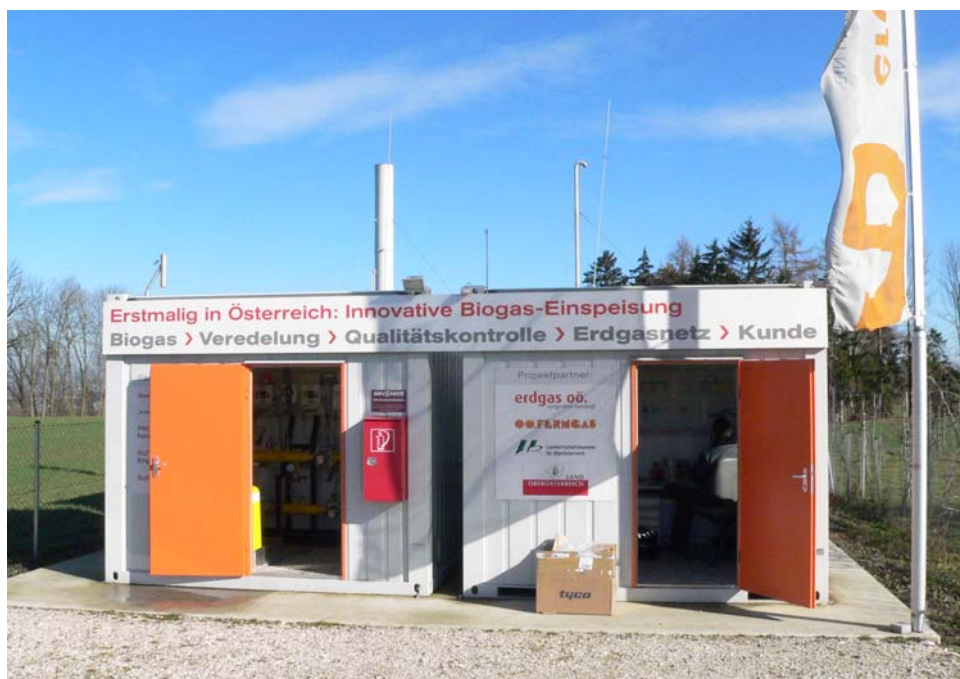
Obr. 8.6: Čisticí a stlačovací jednotka u menší bioplynové stanice v Puckingu (Rakousko)
