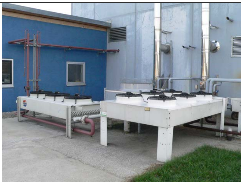
Obr. 8.4: Chladiče pro chlazení motoru kogenerační jednotky
