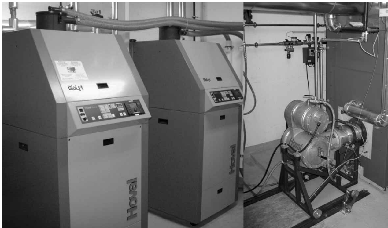
Peletový dvojkotel BioLyt (2 x 70 kW) se Stirlingovým motorem, zdroj Hoval
