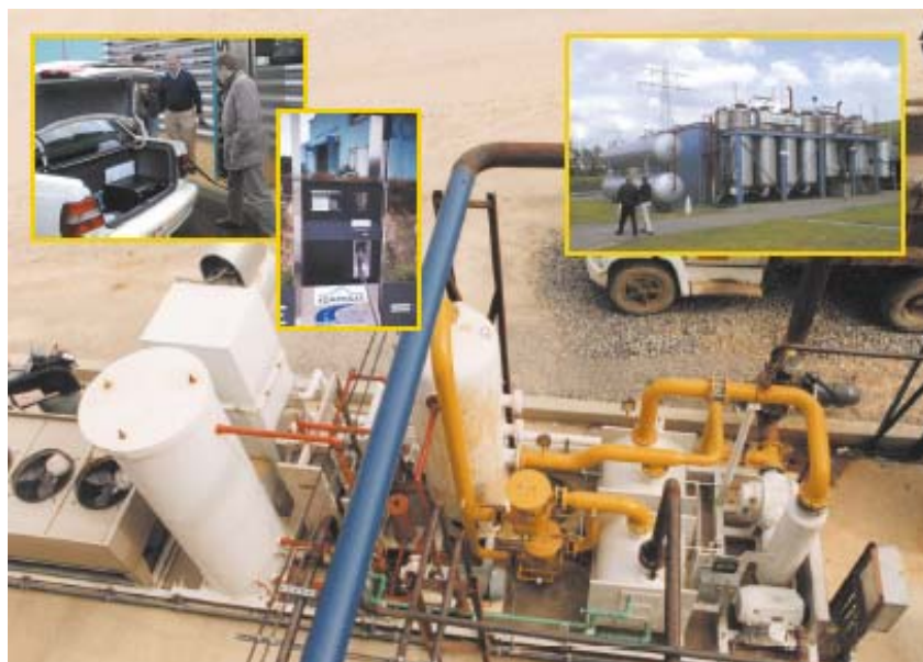
Obr. 3.15: Příklad stanice pro komplexní čištění surového bioplynu
