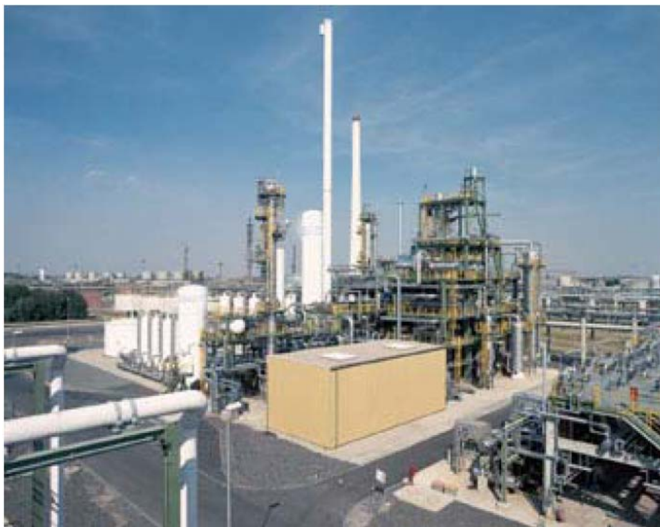
Obr. 3.32: Jednotka na výrobu vodíku parním reformováním zemního plynu
