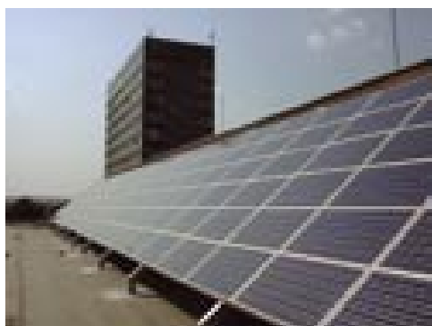
Plocha solárních modulů fotovoltaického systému na budově UK v Praze - Tróji (obr. 7)
