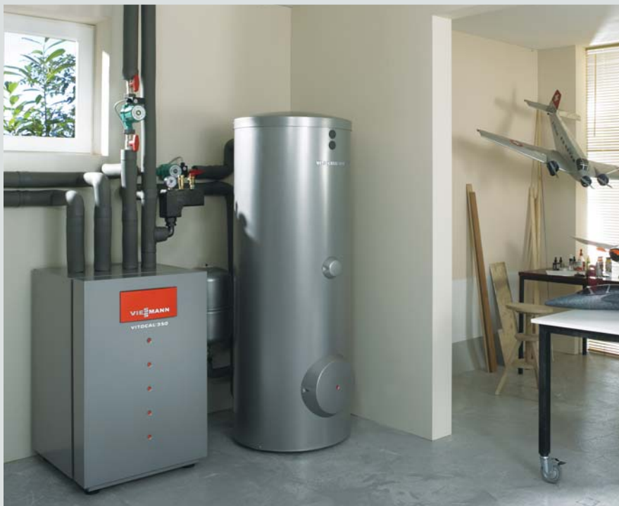
Obrázek 44: Topné zařízení s tepelným čerpadlem
