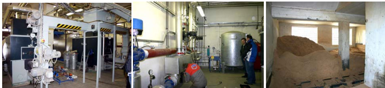
Obrázek 13.1 Kotelna na biomasu Valašská Bystřice
