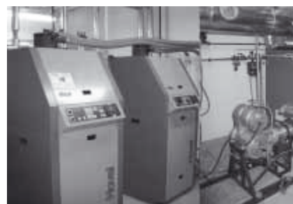
Peletový dvojkotel Hoval BioLyt (2 x 70 kW) se Stirlingovým motorem
